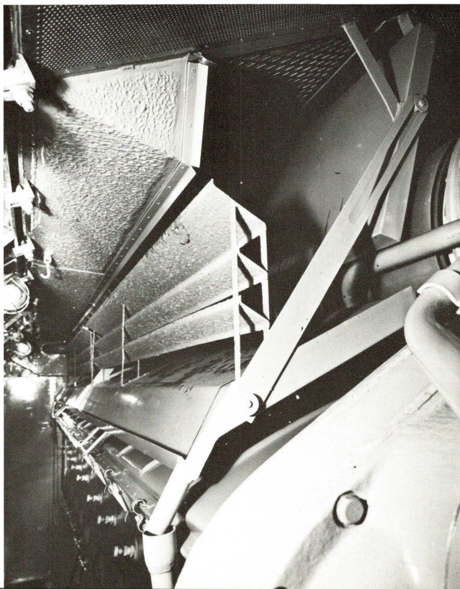
Dieselmotorens lydafskærmning. Foroven ses luftfiltre og derunder de opklappelige skærme med vandafløb. Foran udstødssamlerne ses en skråtstillet lydskaerm.
